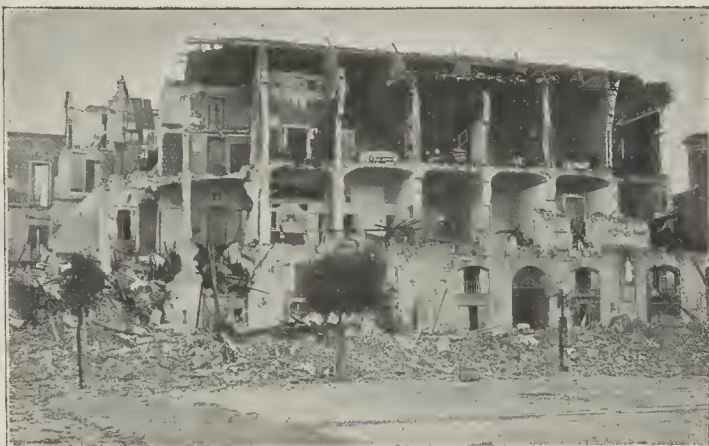
Mesina.—Casa destruida por el terremoto; una mitad fué reducida á escombros, la otra mitad quedó en pie. (De fotografía de Menasci-Dubois, remitida por Carlos Trampus.)
